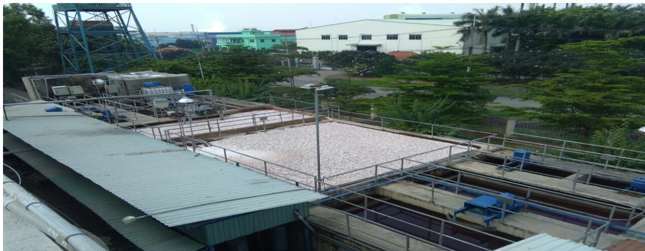
Hình 3.7. Hệ thống XLNT công suất 500 m³/ngày đêm và bể chứa nước thải tại dự án
