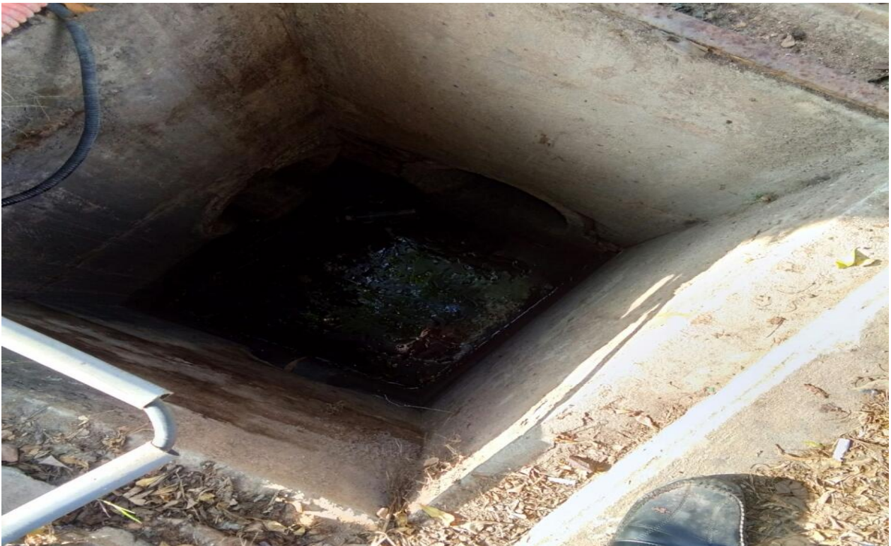
Hình 3.2. Hố ga đầu nối nước thải của KCN
