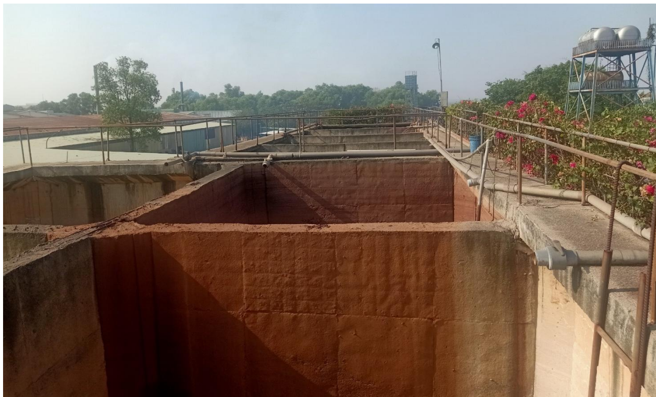
Hình 3.8. Bể chứa nước thải thể tích 1.869 m 3
