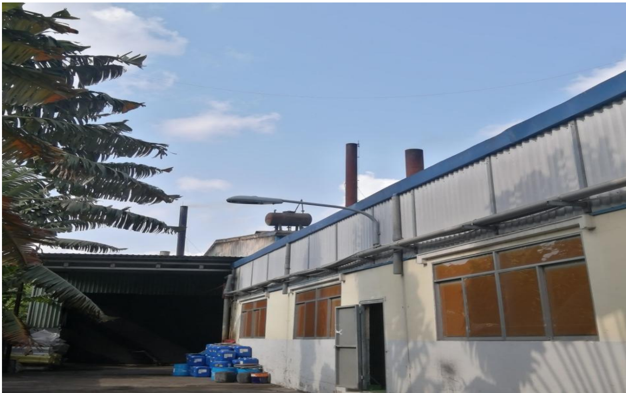
Ống thoát khí thải lò hơi và lò nhiệt
