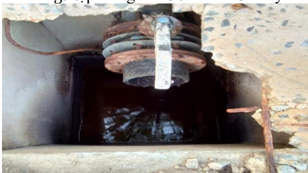
Hồ ga đầu nối nước thải với KCN trên đường số 3
