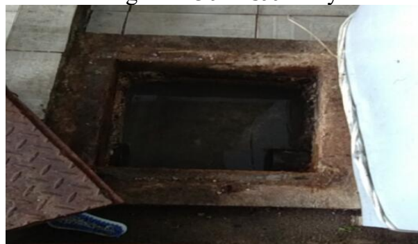
Bể tách mỡ nước thải nhà ăn
