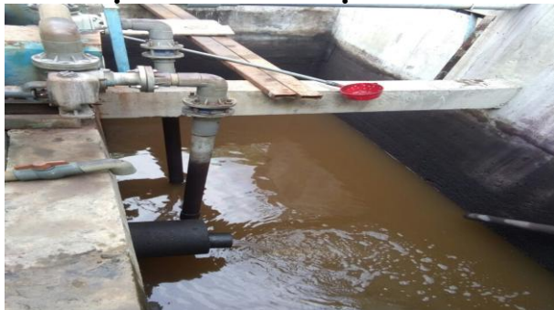
Hồ ga tập trung nước thải trước xử lý
